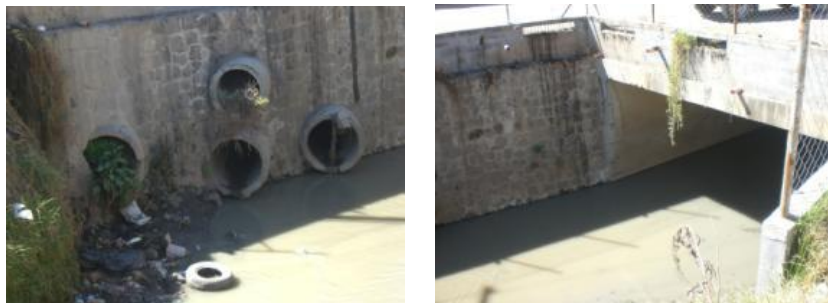
Desfogue municipal 1, zona 2 de Quetzaltenango
