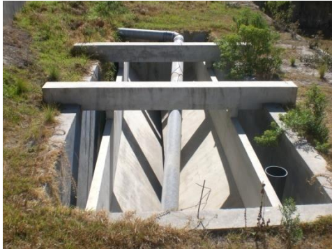
Planta de tratamiento 1, no está en funcionamiento
