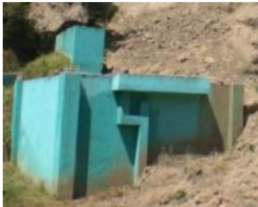
Planta de tratamiento 4, Se encuentra en riesgo por los constantes derrumbes.
